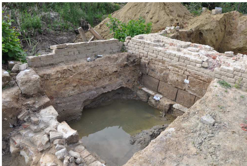
011. De meest noordelijke overspanning van de brug. De grens van het oorspronkelijke metselwerk ten opzichte van het vervangen metselwerk bevindt zich op de overgang tussen het natuursteen- en het bak-
