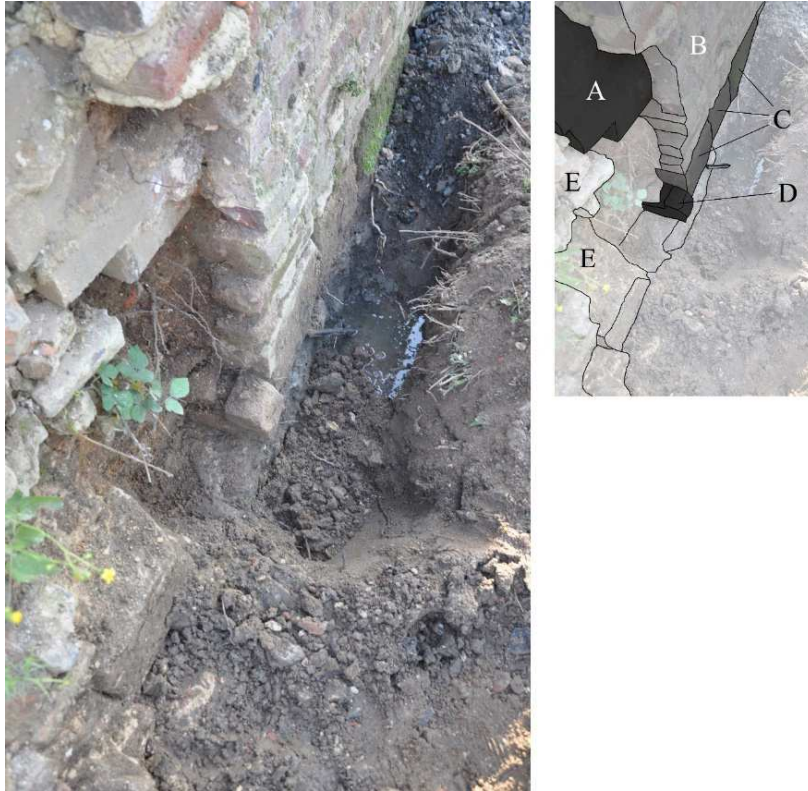
023. Detail van de westelijke aansluiting van de brugconstructie op de poortoren. Het metselwerk ter plaatse van de brug sprong uit ten opzichte van de noordgevel van de bouwhoeve. Door de sloop- en consolidatiewerkzaamheden en de aanleg van de gracht is de hoeveelheid oorspronkelijk metselwerk sterk verminderd. Bij A is de kern van betonblokken van de consolidatiewerkzaamheden zichtbaar. Het metselwerk bij B is eveneens bij de consolidatie tot stand gekomen, hoewel de grens met het oorspronkelijke werk nog niet kon worden vastgesteld. De natuurstenen blokken bij C behoren wel bij het oorspronkelijke werk (zie hiervoor ook de foto's van vóór de sloop). Het metselwerk bij D is in baksteen uitgevoerd en steekt uit ten opzichte van het geveoppervlak. Vanaf dit punt ontbreekt ook het natuursteen. Dit is de overgang naar het vooruitspringende deel ter plaatse van de brug. Dit deel is ook niet voorzien van natuurstenenblokken. Bij E is het oorspronkelijke 17de-eeuwse metselwerk zichtbaar.
